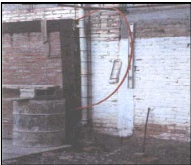
Figura 1. Tubería de conducción de agua de lluvia.
